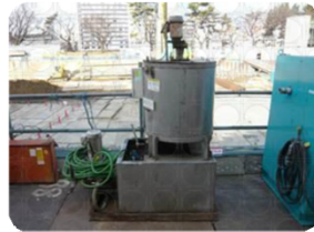
消泡剤調整槽
